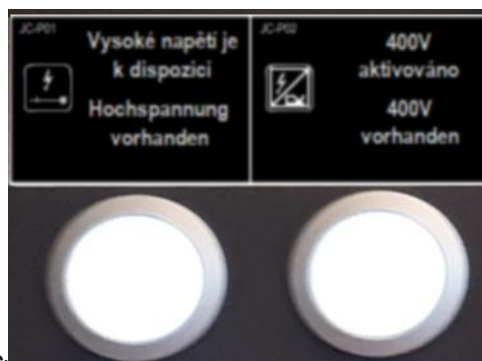
Obrázek 264 - Světelný hlásič „Vysoké napětí přiloženo“ a „400V přiloženo“
